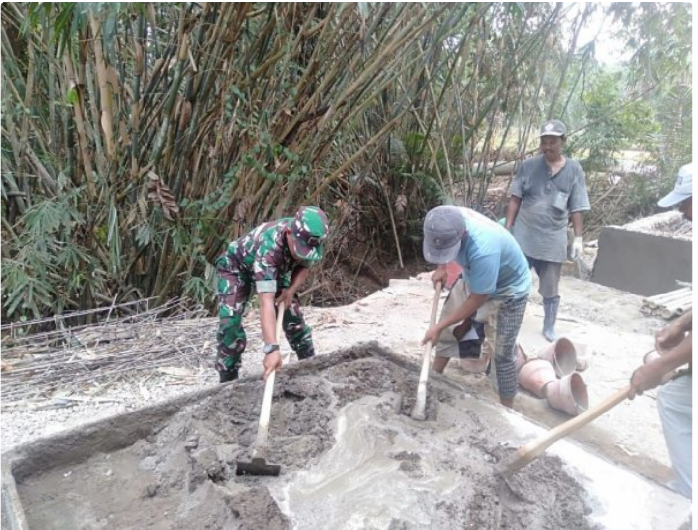
Babinsa Koramil 0829-04/Burneh, Serka Dwi Hartanta Bahu membahu bersama masyarakat membangun jembatan
